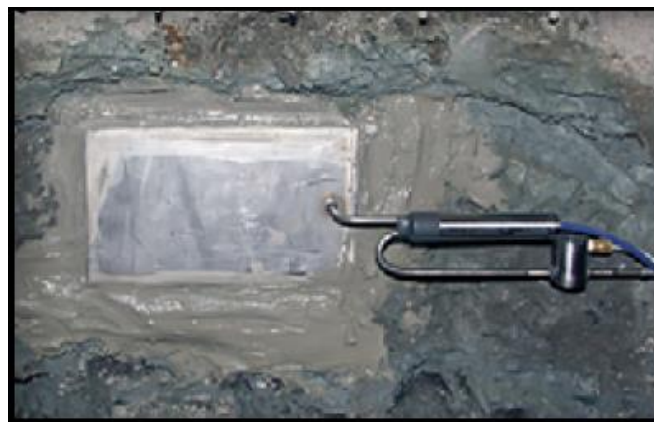
Figura 2.17 - Célula de carga instalada no maciço rochoso anteriormente ao lançamento do concreto projetado - Geokon (2016).
