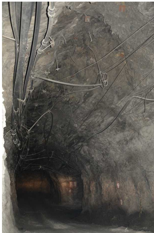
Figura 4.9: Estágio elevado de ruptura, iniciado pelo buckling no Nível 13 da rampa FGS e formação de “capela”.
