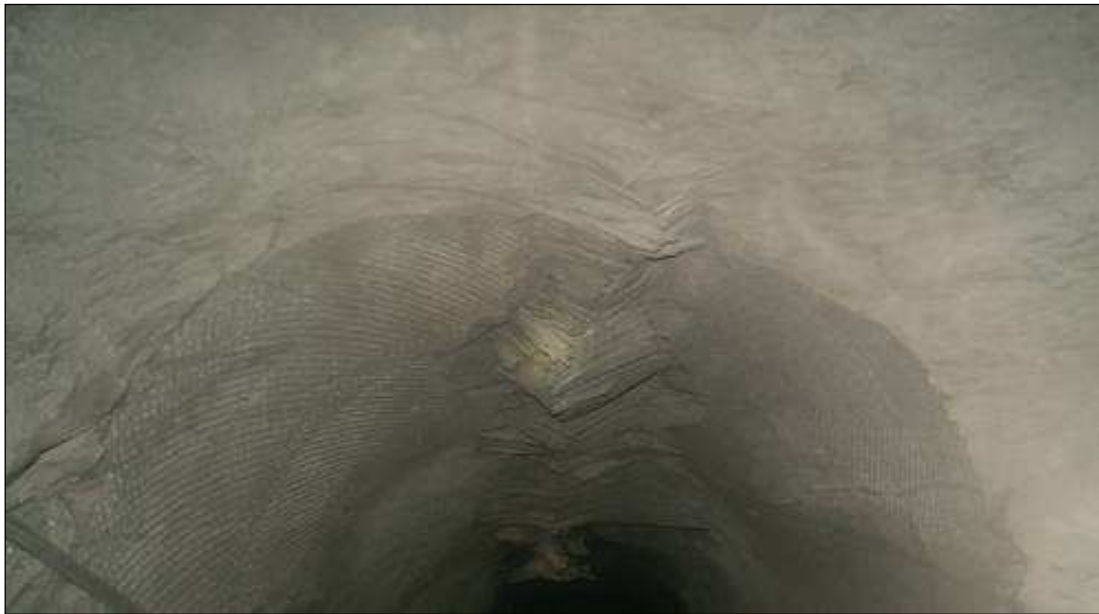
Figura 2.36: Buckling na parte superior do furo de ventilação (localizado no realce 15 Fonte Grande Sul lado direito, 900m de profundidade, da mina Cuiabá (Tropia, 2013).
