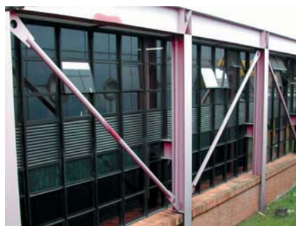
Figura 13 - Estado da pintura da estrutura metálica.
