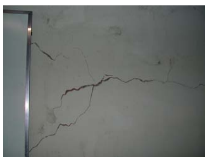
Figura 17 - Trinca em parede devida à infiltração.
