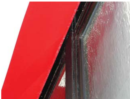
Figura 19 - Infiltração de água de chuva no contato estrutura-esquadria.
