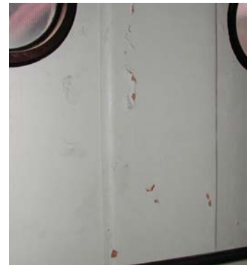
Figura 21 - Descascamento devido à infiltração.
