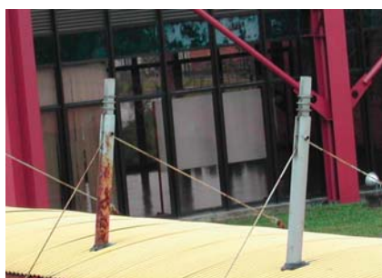
Figura 14 - Corrosão em peça da passarela.
