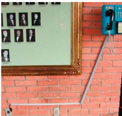
Figura 22 - Dificuldade de embutimento de fiação.
