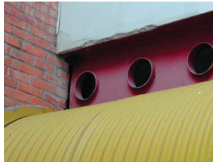
Figura 20 - Descascamento no contato estrutura-alvenaria.
