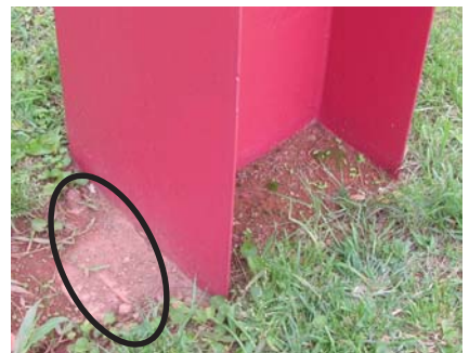
Figura 12 - Corrosão em frestas em parafusos de fixação de pilares.
