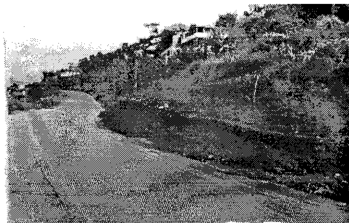
Foto 3. Muro tipo gabião deformado na Estrada Ouro Preto - Passagem de Mariana.
