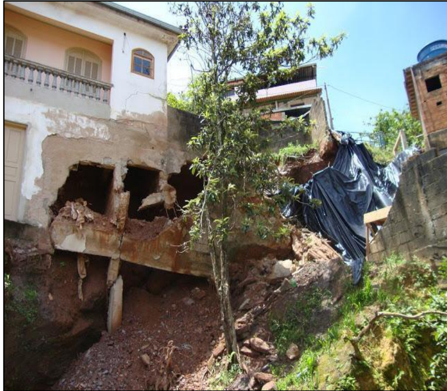
Figura 19 – Desmoronamento de parte de uma residência em cima da entrada da galeria subterrânea
