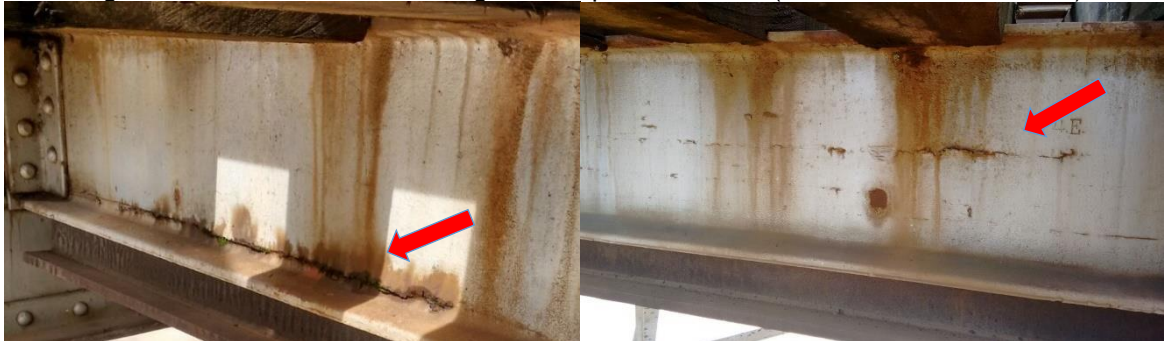
Figura 24 - Trinca na alma da longarina de perfil laminado (sem redundância interna)
