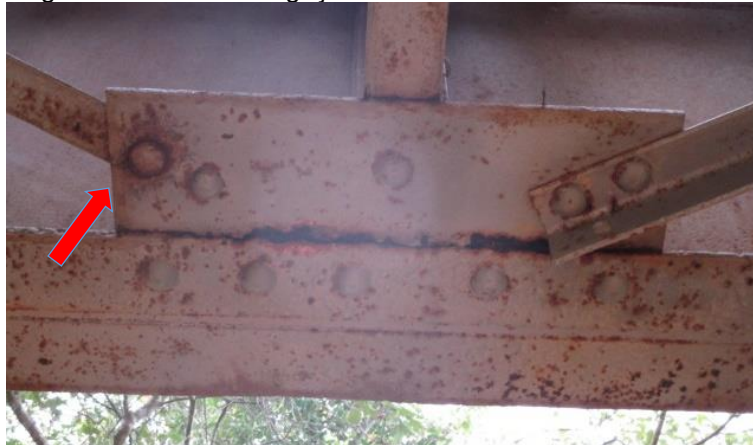
Figura 21 - Trinca na ligação do contraventamento inferior
