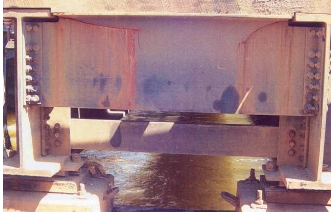
Figura 23 - Trinca em elemento secundário sem redundância
