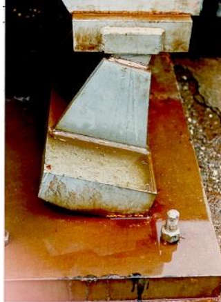
Figura 26 - Deslocamento excessivo do aparelho de apoio
