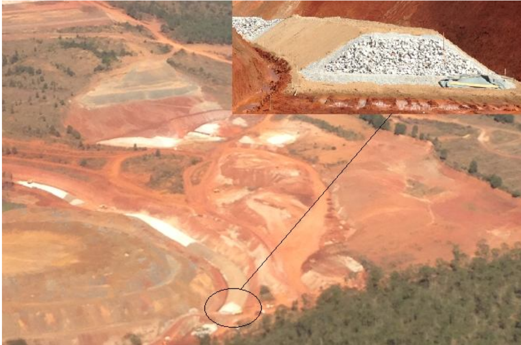
Figura 4.1 - Ilustra a imagem de um dispositivo de drenagem interna em desenvolvimento, evidenciando as transições filtrantes. (Dados de relatório de projeto, VALE S.A)
