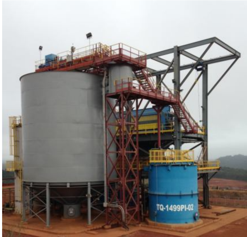
Figura 2.5 – Espessador de alta capacidade em operação na Mina do Pico, 2017.
