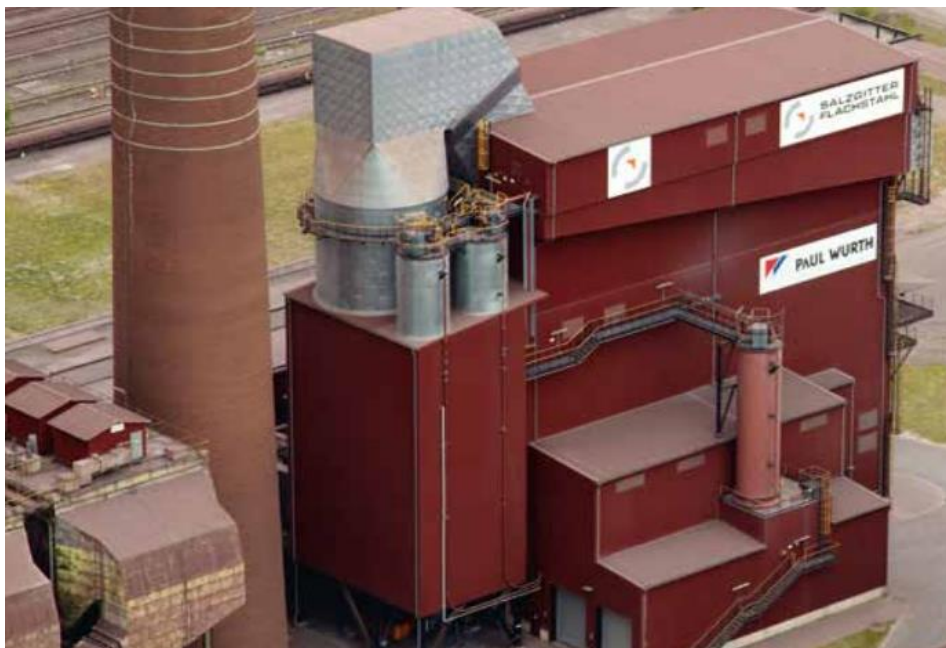
Figura 10 - Sistema de Despoeiramento. Fonte: Paul Wurth
