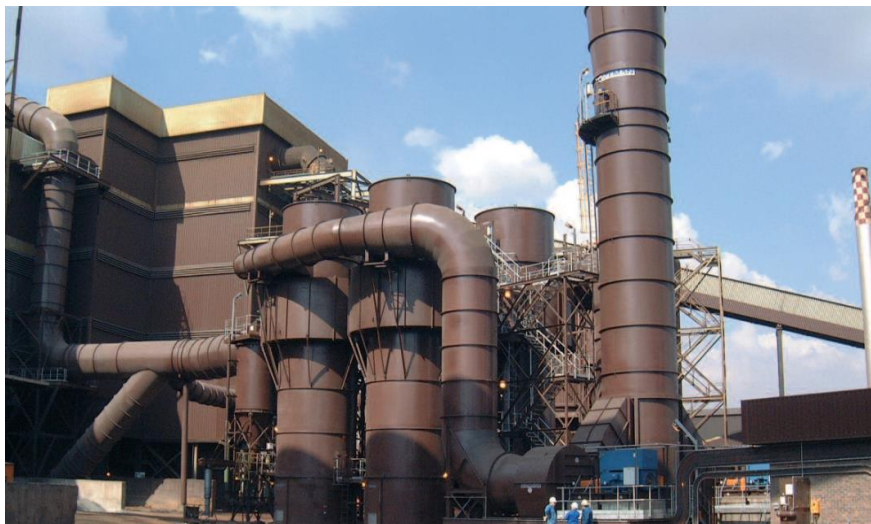
Figura 18 - Sistema de Despoeiramento. Fonte: TENOVA
