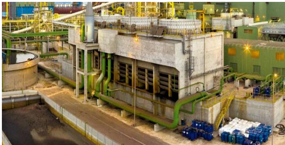
Figura 20 - Sistema de Resfriamento de Água. Fonte: TENOVA
