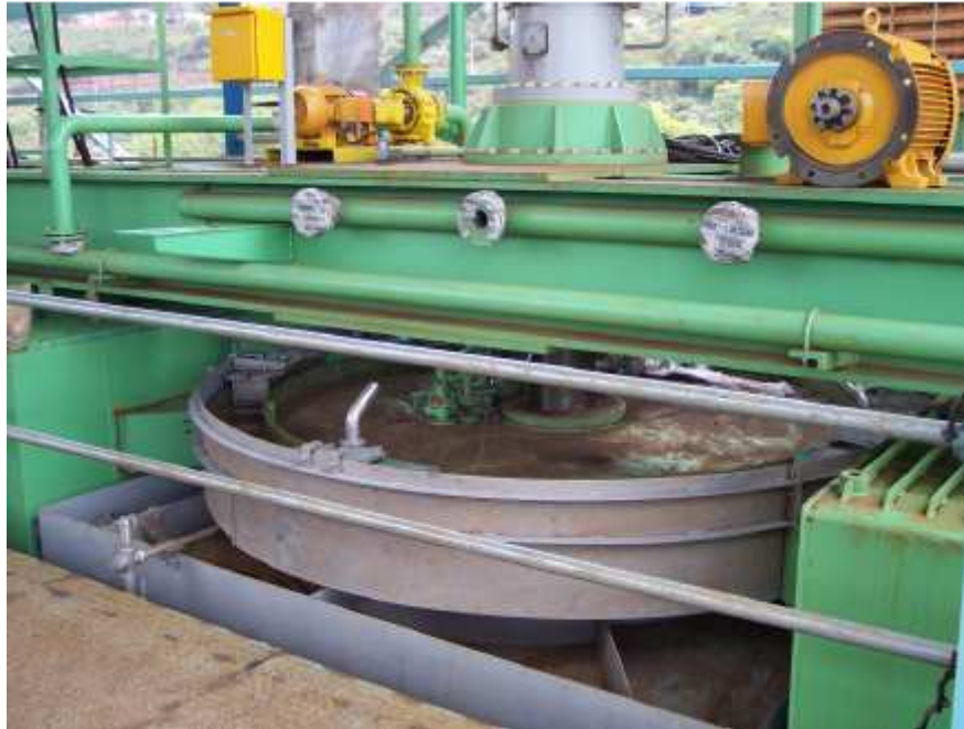
FIGURA 5: Concentrador Magnético tipo Jones ou Carrossel instalado na Mina de Alegria/MG (SOUZA, 2010).
