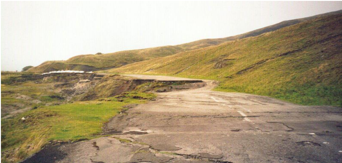
Figura 3.7 Subsidência: uma seção de uma estrada próximo à Castleton, UK, destruída por subsidência geológica. Este episódio levou ao fechamento desta estrada. Fonte: http://en.wikipedia.org/wiki/Image:SubsidedRoad.jpg – (Acesso em:08/02/2012)
