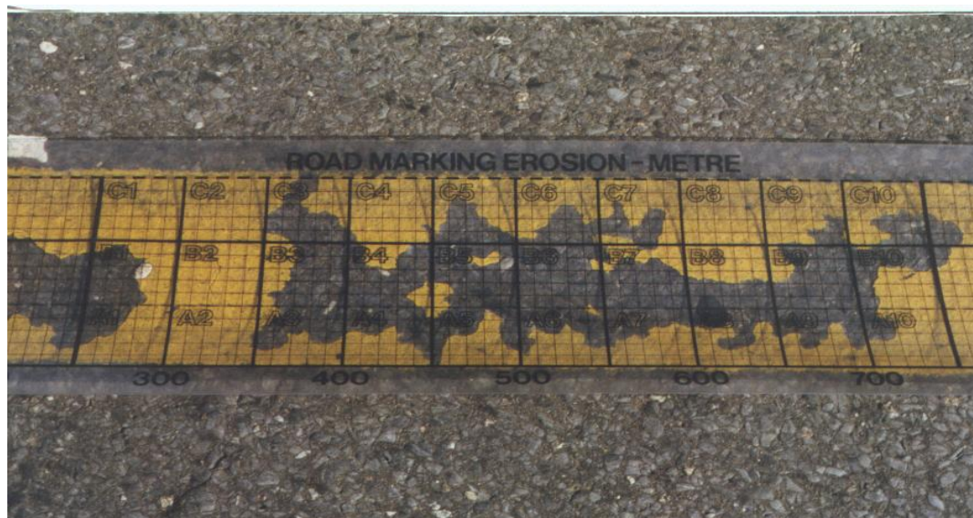
FIGURA 3.7. – Medição de desgaste com utilização da grelha
