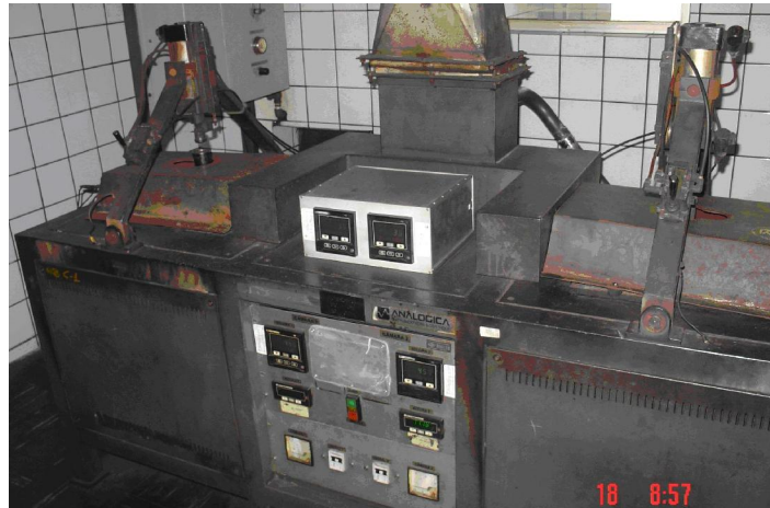
Figura 30 . Fotografia do forno de soleira aquecida da Arcelor.Mittal Tubarão
