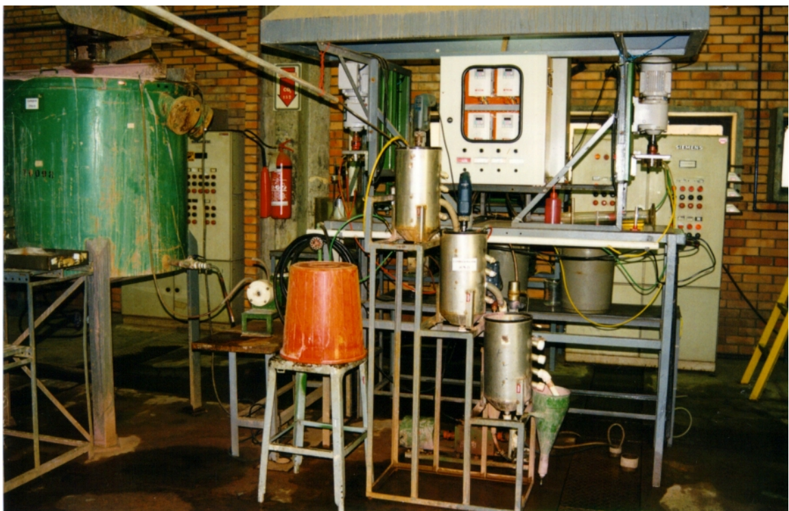
Figura 4.8 - Vista dos condicionadores.
