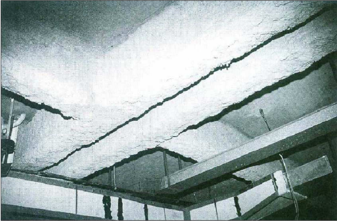
Figura 4.10 – Vigas de aço revestidas com argamassa de vermiculita, por meio de “spray” (COSTA, 2001)
