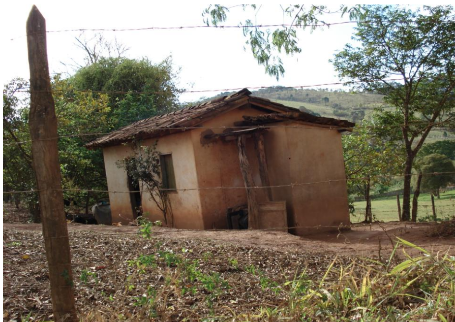
Figura 4.14 - Casa em condições precárias na comunidade de Cristais
