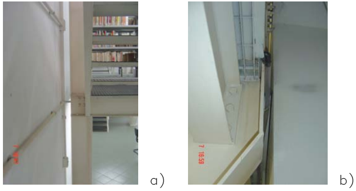
Figura 6.82 a e b – Ligações parafusadas viga x pilar. Fonte: Arquivo particular do autor, julho de 2006.
