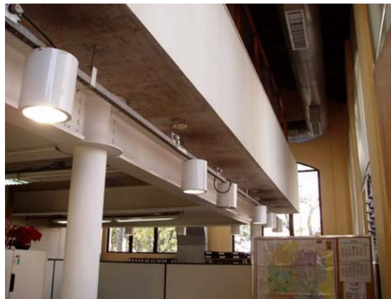
Figura 6.95 – Recuo da estrutura nova das paredes da edificação antiga. Fonte: Arquivo particular do autor, julho de 2006.
