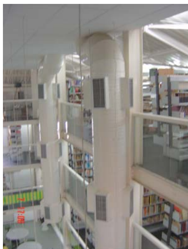
Figura 6.64 – Detalhe do duto de ar condicionado. Fonte: Arquivo particular do autor, julho de 2006.
