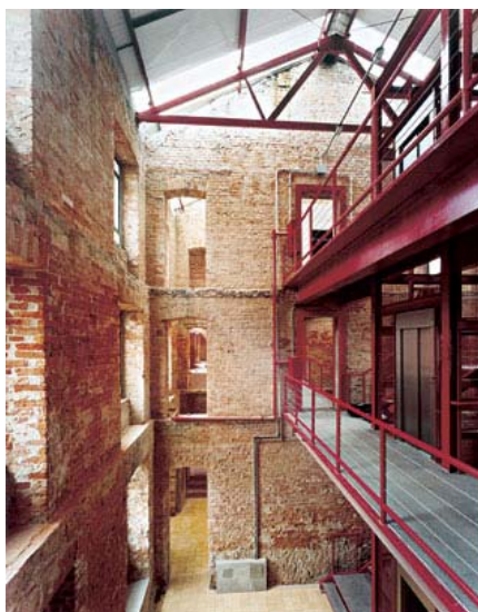
Figura 6.26 - Vista do vazio do primeiro e segundo pavimento. Fonte: SERAPIÃO, Fernando, abril de 2005.
