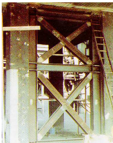
Figura 4.3 -Reforço após ocorrência de um sismo. Fonte: CALADO, 1997, p.20-25.
