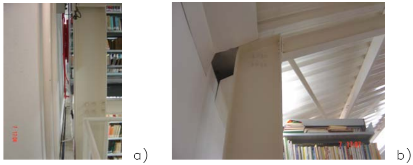
Figura 6.83 a e b – Ligações parafusadas. Fonte: Arquivo particular do autor, julho de 2006.
