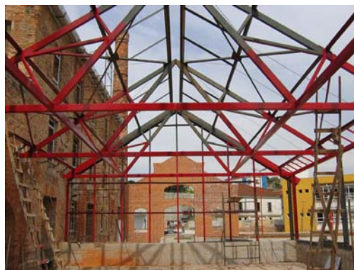
Figura 6.19 – Estrutura metálica se erguendo no local do antigo galpão 3. Fonte: Arquivo particular do arquiteto Rafael Perrone.
