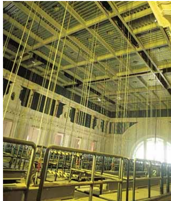
Figura 2.14 - Forro acústico sustentado por cabos de aço. Fonte: ZEIN, Ruth Verde; DI MARCO, Anita Regina, 2001.p.226.
