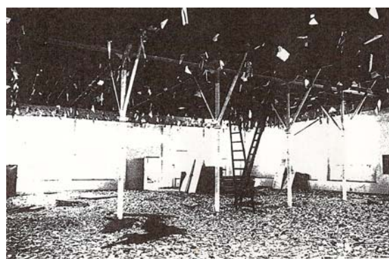
Figura 6.97 – Colunas centrais para sustentação das tesouras. Fonte: ESPAÇO TEMPO ▯ ARQUITETURA/URBANISMO/RESTAURAÇÃO DE BENS CULTURAIS,
