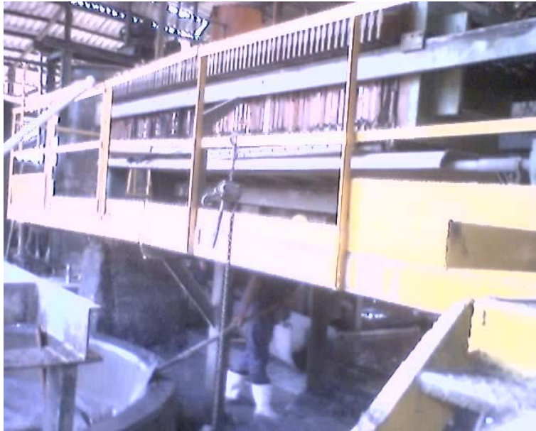
Figura 4.4 - Filtro prensa utilizado no processo de fabricação de sulfato de zinco
