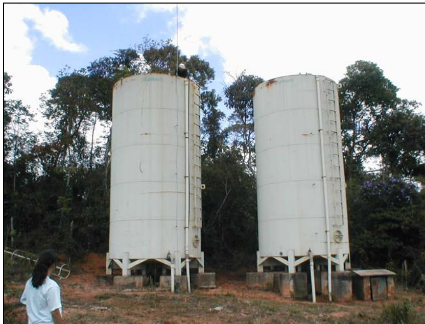
Figura 3.1.3: Reservatórios Martins Vasconcelos I e II.
