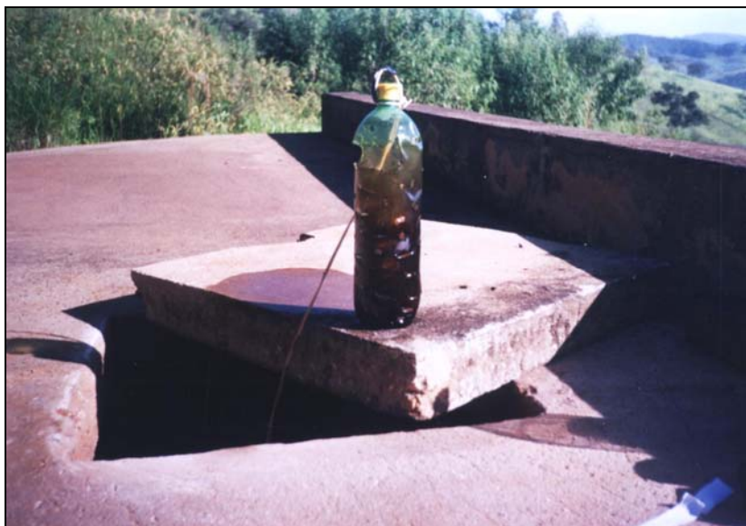
Figura 3.1.4: Sistema de cloração da água no reservatório Engenho I.
