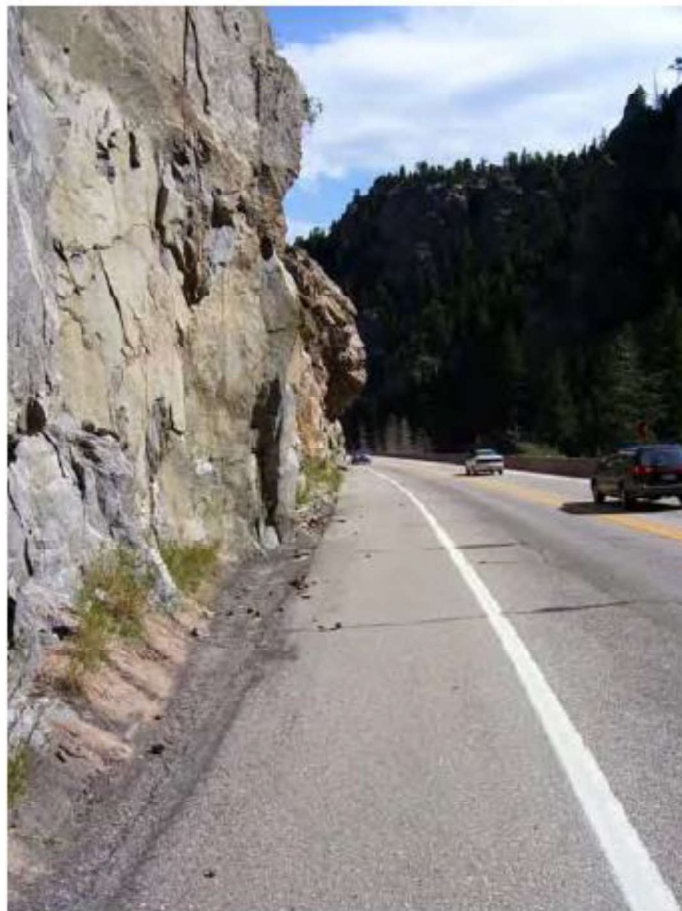
Figura 2.13 – Exemplo de um talude cristalino que pontua 81 para o grau de descalçamento no CRHRS modificado (Russel et al. , 2008).
