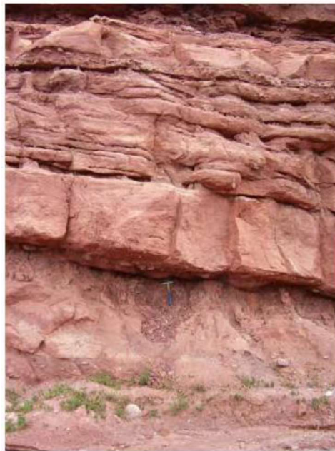
Figura 2.14– Exemplo de descalçamento em talude de rocha sedimentar (Russel et al. , 2008).
