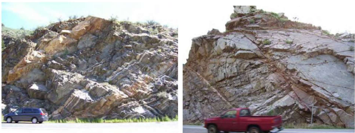
Figura 2.17– À esquerda: descontinuidades persistentes ( > 3 m), com uma direção de mergulho favorável em relação ao talude e à estrada (pontuação de 9). À direita: descontinuidades persistentes ( > 3 m) com uma direção de mergulho adversa em relação ao talude (Russel et al. , 2008).
