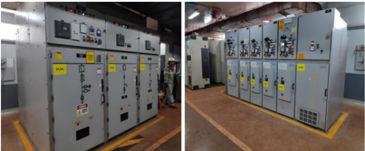
Figura 3-7: Exemplo de equipamentos dentro de uma subestação elétrica do TPPM. Em destaque, conjuntos de manobra de 34,5 kV e 4,16 kV, respectivamente.
