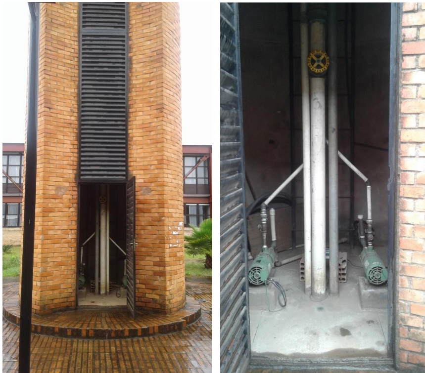
Figura 23: Casa de bombas e tubulações de recalque e de distribuição do reservatório superior da Escola de Minas
