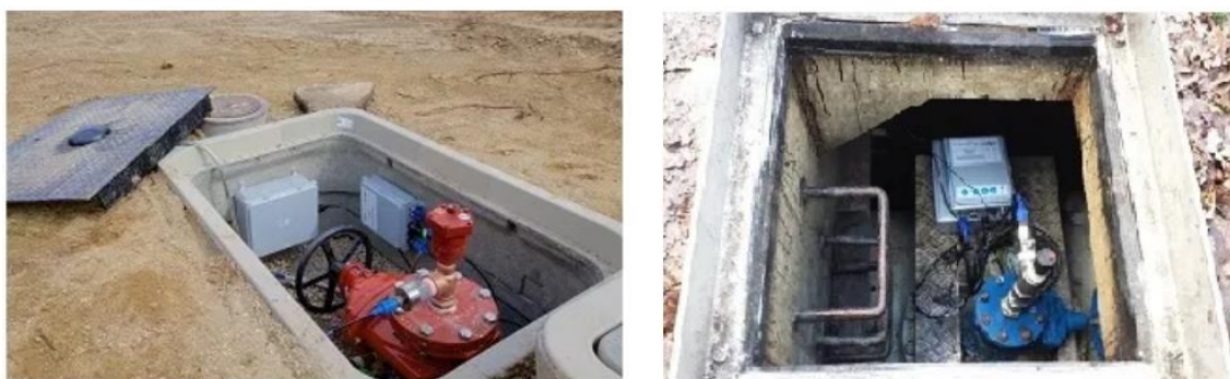
Figura 15: Monitoramento da rede de água através de correlacionadores acústicos inteligentes ligados ao SIG.
