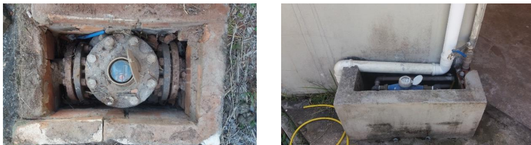
Figura 36: Hidrômetro DN 150 (3") na entrada do Reservatório 2 (à esquerda) e Hidrômetro DN 40 (1 1/2") na entrada do prédio do Centro de Saúde/Farmácia do campus (à direita).
