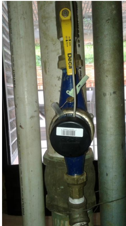
Figura 27: Hidrômetro pulsado instalado
