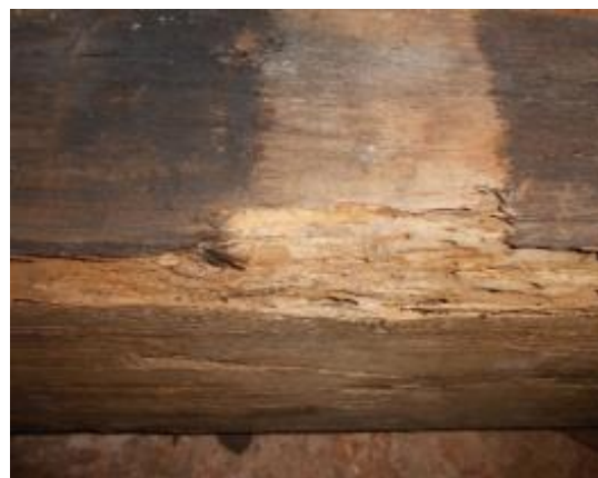
Figura 3-44: Madeira retirada da Matriz de N. Sr. a da Conceição, deteriorada por xilófagos. Fonte: arquivo pessoal.
