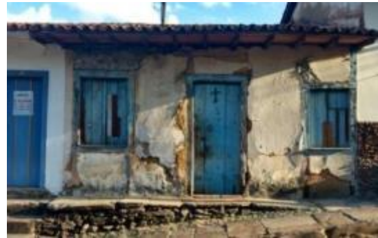
Figura 3-32: Casa em pau a pique, com parede em estado ruim de conservação, em Ouro Preto, MG. Fonte: arquivo pessoal.
