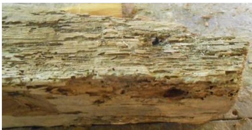
Figura 3-45: Madeira retirada da Matriz de N. Sr. a da Conceição, bastante deteriorada por cupins. Fonte: arquivo pessoal.
