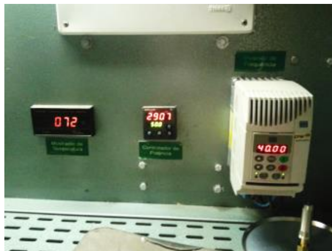
Figura 4-19: Monitor de temperatura, controlador de potência e inversor de frequência da exaustão da bancada do calorímetro cônico. Fonte: arquivo pessoal.
