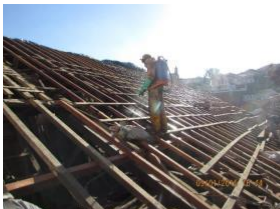
Figura 3-47: Trabalho de imunização por aspersão da estrutura do telhado. Foto: CONTRUTUTORA AMBIENTAL, 2015.
