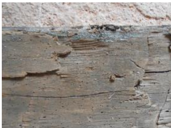
Figura 3-43: Madeira retirada da Matriz de N. Sr. a da Conceição, com furos, indicando a presença de xilófagos. Fonte: arquivo pessoal.
