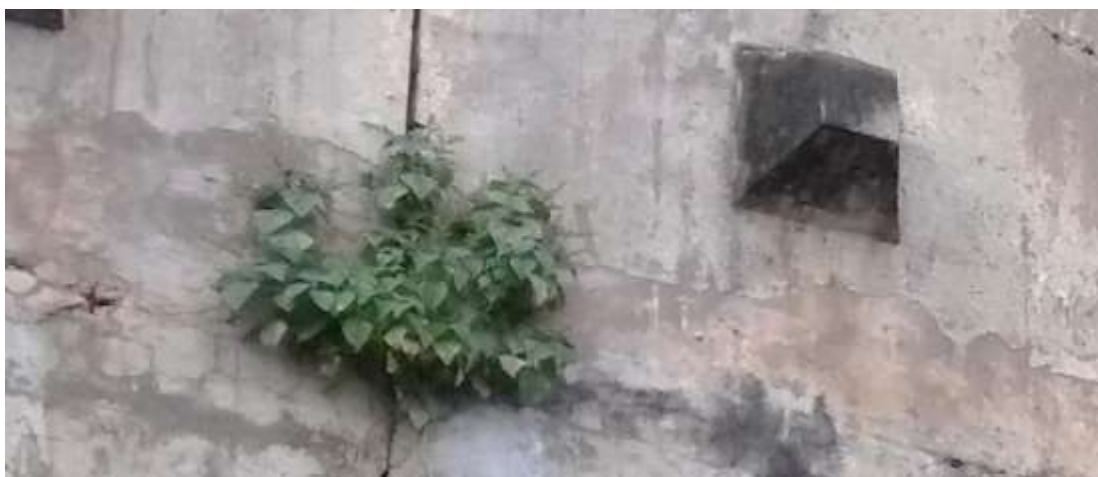
Figura 2-15 - Vegetação na junta da contenção da Avenida Nossa Senhora do Carmo. (DEER, 2018).
