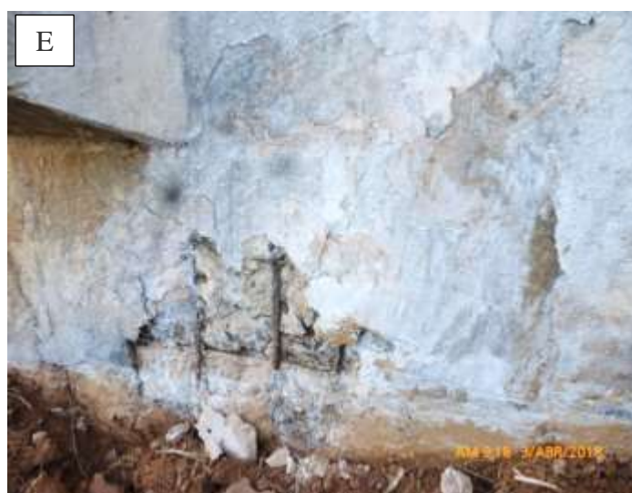
Figura 2-17 - Patologia no painel de concreto da Avenida Nossa Senhora do Carmo. (A, D e E) Desagregação e Corrosão, (B) Surgência de água, (C) Fissuração (DEER,2018).
