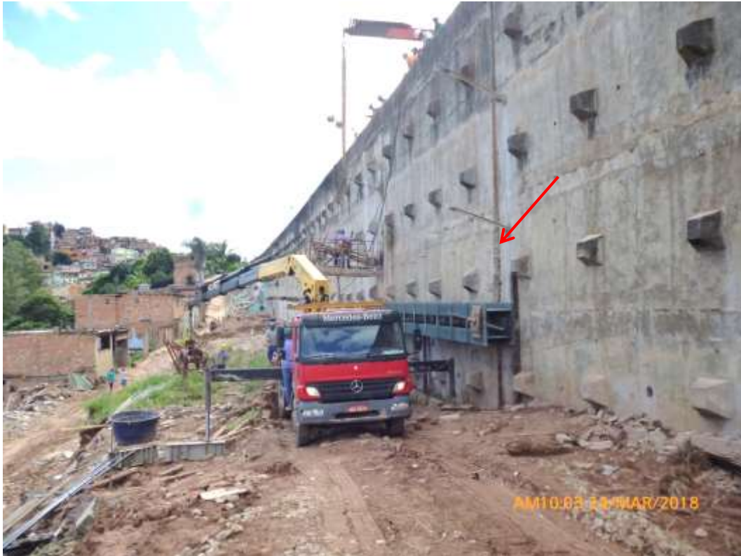
Figura 2-16 - Deslocamento das juntas na contenção da Avenida Nossa Senhora do Carmo. (DEER, 2018).
