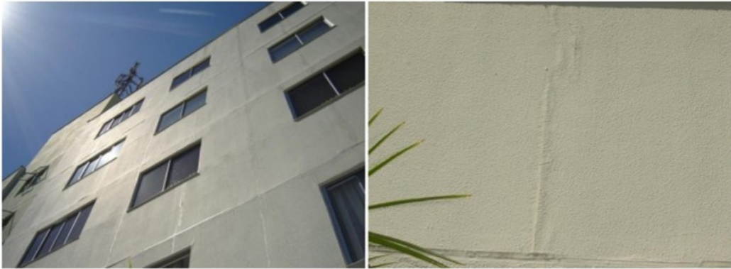
FIGURA 28 - Patologia de trincas e marcação de juntas tratadas em fachada revestida com placas cimentícias
