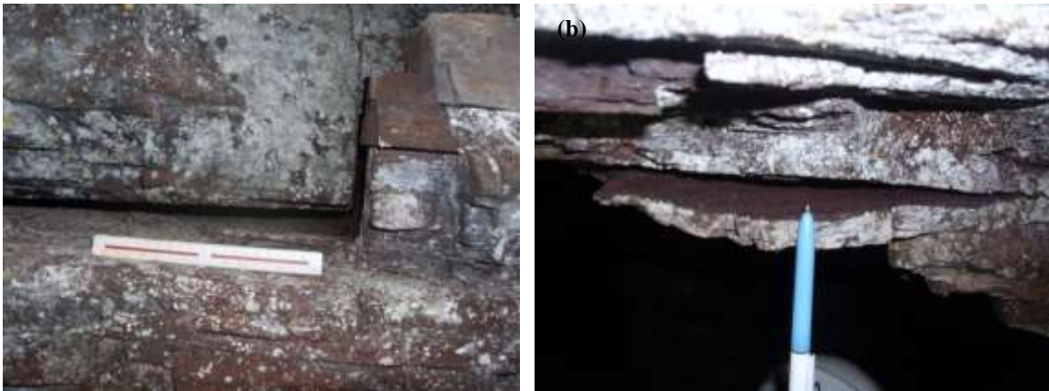
Figura 7.9 – a) Instabilidade no teto segundo acamamento com abertura maior de 5 mm; b) Processo de deslocamento no teto segundo o acamamento do itabirito.
