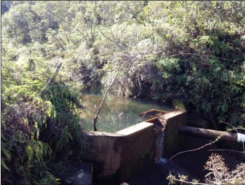
Figura 23: captação principal de Lavras Novas
