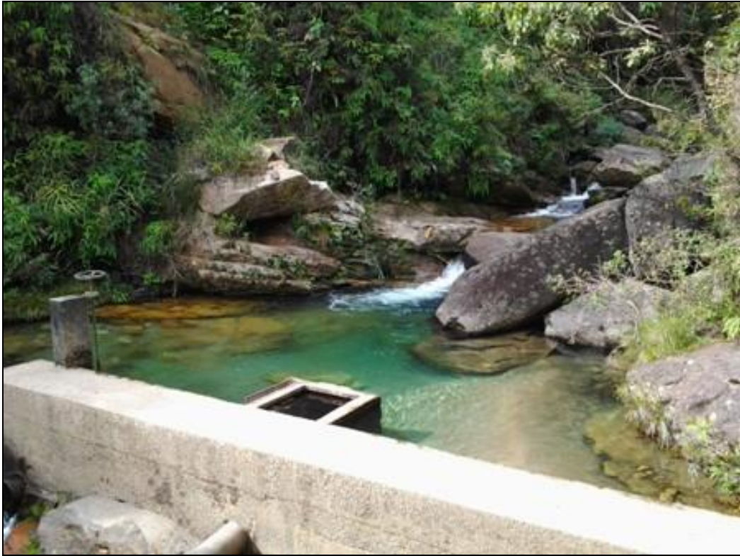
Figura 9: captação da ETA Itacolomi
