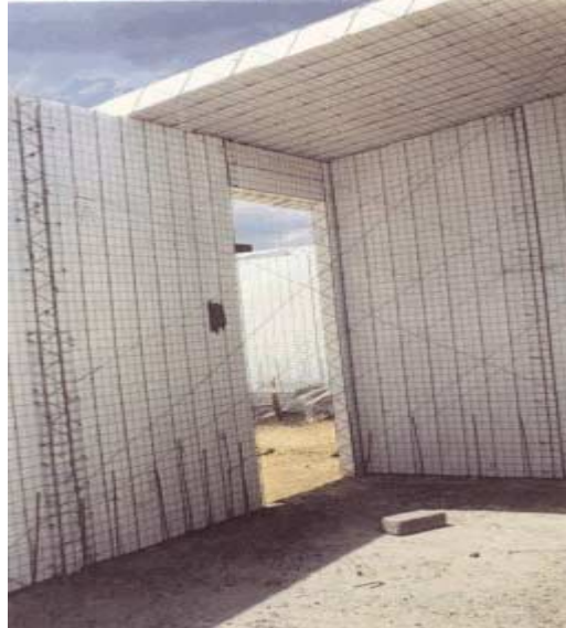
FIG. 2.24 – 1ª Etapa da montagem de paredes e laje em painéis Isolite (Fonte: ISOLITE, 2002)
