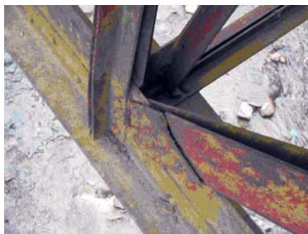
Figura 8 - Diagonal tracionada rompida.
