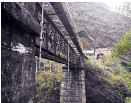
Figura 7 - Vista lateral, onde podem ser observados os pilares em alvenaria de pedra.
