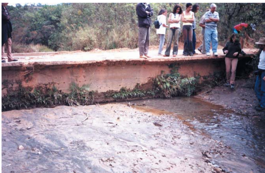
Figura 8 - Detalhe do grau de assoreamento na Ponte do Morro da Mata sobre o córrego Cipó.
