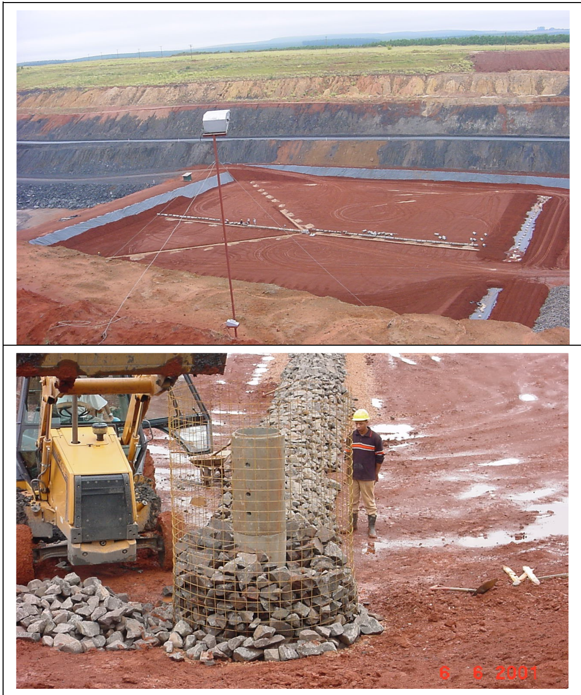
FIGURAS 6.33 - Drenagem do gás
