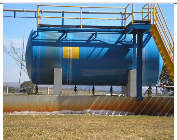
Figura 4.3 – Tanque onde é misturado o sulfato de sódio para remediar a contaminação da água subterrânea.
