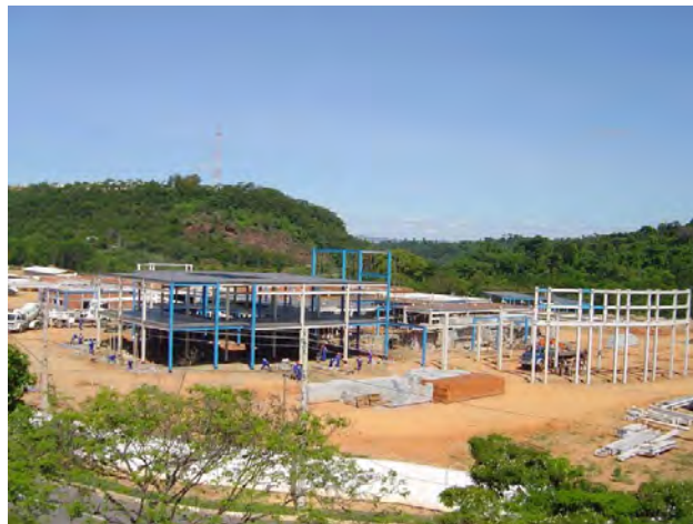
Figuras 5.12 – Montagem das estruturas e fechamento das alvenarias. Fonte: FUNDAÇÃO SÃO FRANCISCO XAVIER, 2009.
