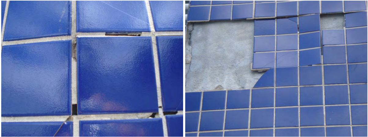
Figura 5.20 – Fissuras, trincas, rupturas e desprendimento de revestimento cerâmico (pastilha 10 x 10 cm), visto a grande dimensão de panos de alvenaria contínuos, confinados entre as estruturas e sem juntas de dilatação.
