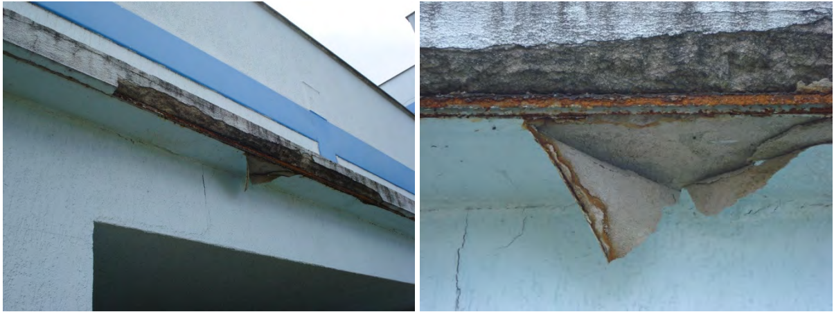
Figuras 5.18 – Após a expansão da corrosão, deu-se o deslocamento da argamassa de revestimento da testada da marquise, assim como o desprendimento da superfície inferior. Fonte: Arquivo Pessoal, 2011.
