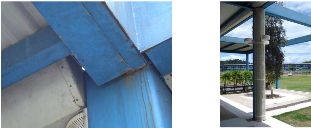
Figura 5.19 – Visto a baixa qualidade do tratamento anticorrosivo (limpeza, fundo e acabamento) inicia-se o processo de corrosão superficial e de conexão calhas/pilares. Fonte: Arquivo Pessoal, 2011.
