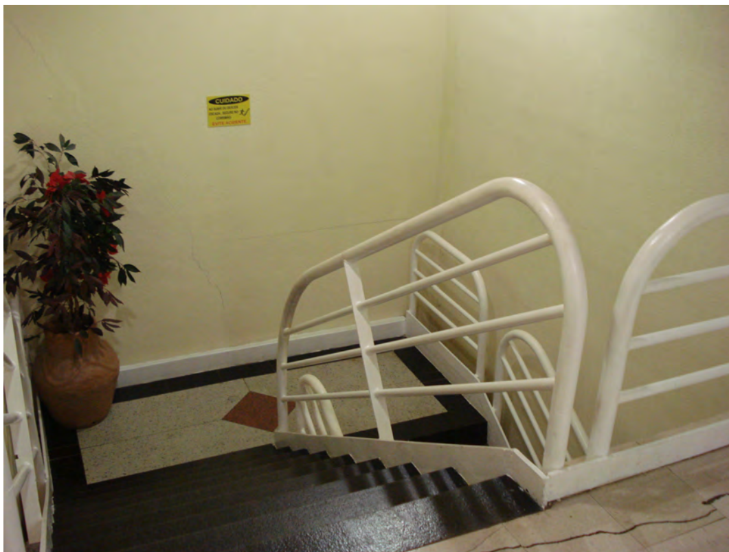
Figuras 5.56 - Trinca na área de circulação do mezanino. Fonte – Arquivo Pessoal, 2011.
