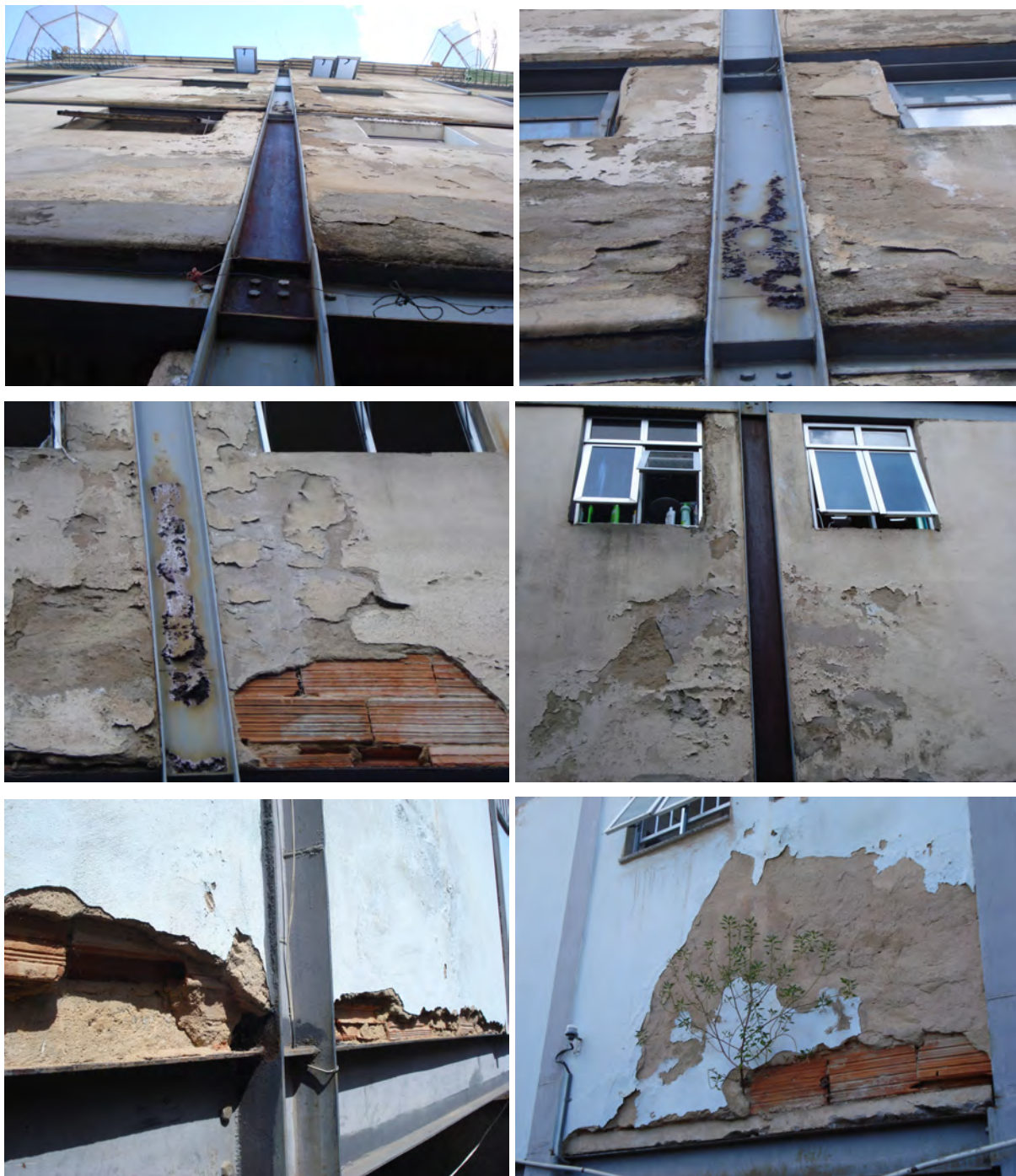
Figuras 5.4 – Patologias pontuais. Fonte: Arquivo Pessoal, 2011.
