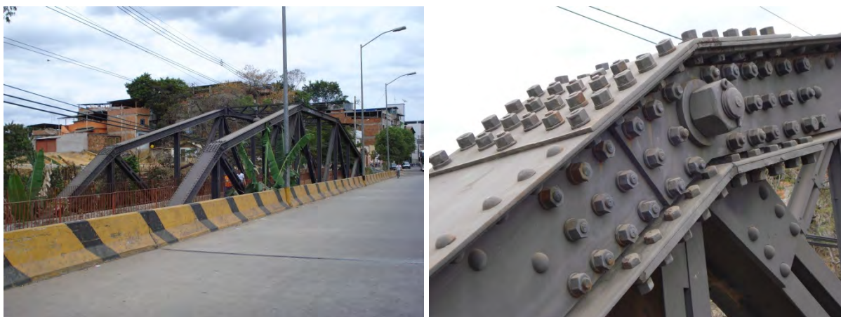
Figura I.40 - Ponte Ferroviária Urbana Remanescente da CVRD ora utilizada como passarela de ligação Centro/ Bairro Veneza II.
