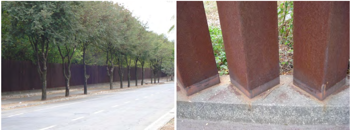
Figura I.42 - Fechamento periférico Padrão da Usina Intendente Câmara – USIMINAS (Extensão implantada aproximadamente 8.000 m.).
