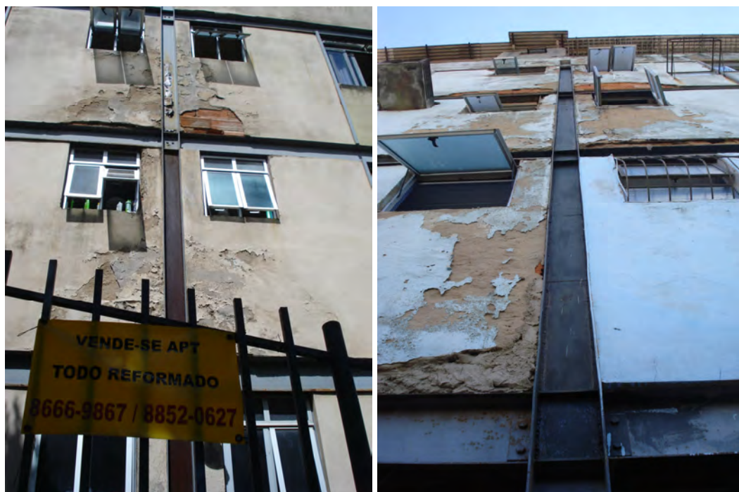
Figuras 5.4 – Patologias pontuais. Fonte: Arquivo Pessoal, 2011.
