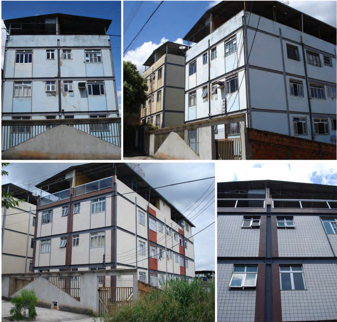
Figuras 5.5 – Fachadas antes e depois da recuperação – Bloco I. Fonte: Arquivo Pessoal, 2011.
