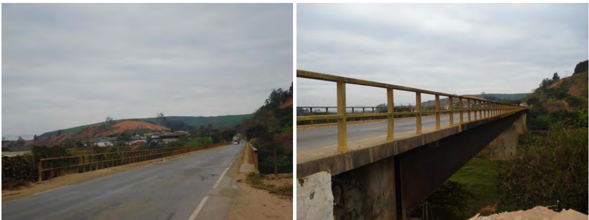
Figura I.47 - Ponte Rodoviária sobre o Rio Doce (Extensão 345m/Largura total 10m/Pista 8,20m) Rodovia BR: 458 Km 140 – Trecho: Entroncamento BR 116 c/ BR 381 Ipatinga 1969.
