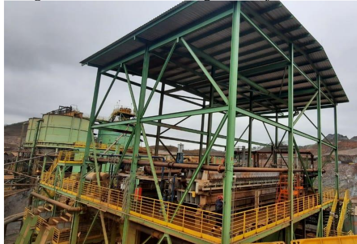
Figura 22 - Unidade da filtragem de rejeito Ferro+
