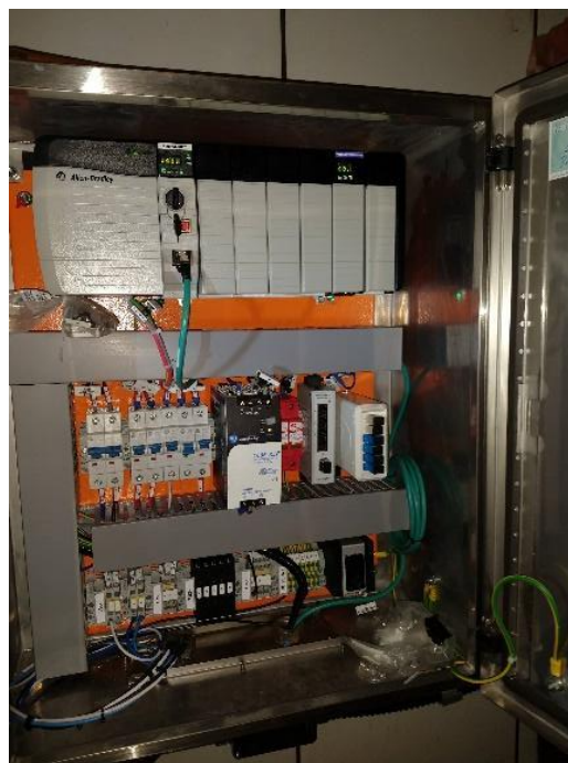
Figura 8 – Painel PLC Balança Ferroviária
