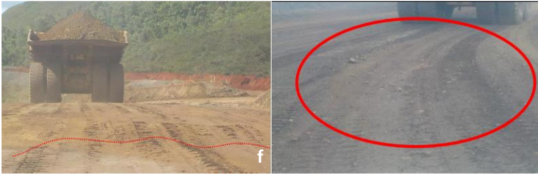
Figura 36 - Defeitos encontrados nas estradas
