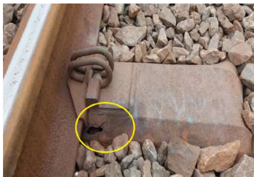
Figura 2.5: Sintomas da perda da capacidade estrutural dos dormentes de aço (corrosão).
