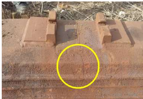
Figura 2.4: Sintomas da perda da capacidade estrutural dos dormentes de aço (trinca).
