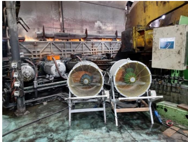
Figura 5.37. Ventiladores utilizados para minimizar a temperatura da parte estrutural da porta
