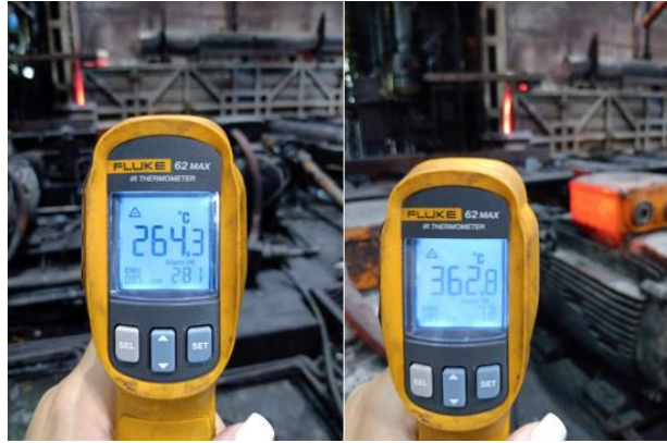
Figura 5.35. Monitoramento térmico da região com desprendimento de bloco.
