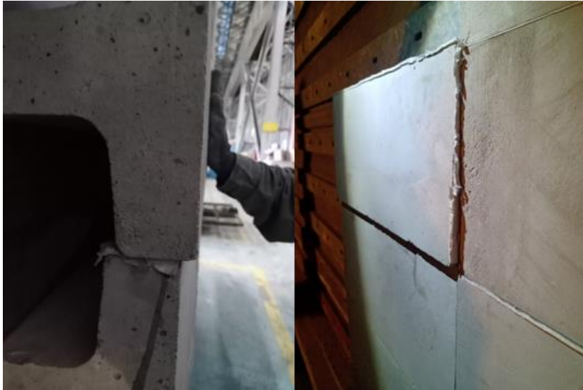
Figura 5.26. Desnível entre os blocos.
