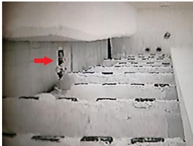
Figura 5.36. Região de desprendimento dos blocos refratários.
