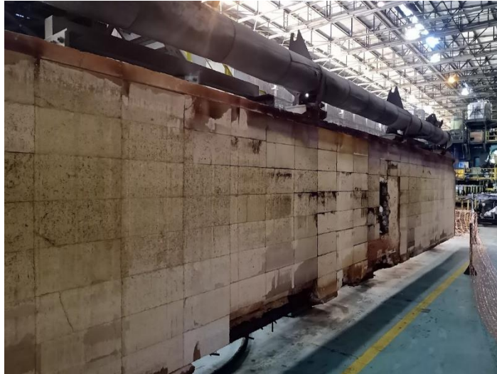
Figura 5.39. Condição da porta seca após ter sido retirada do forno.
