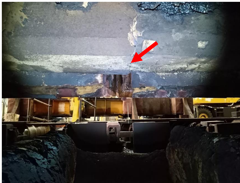
Figura 3.6. Vazamento de água decorrente da água de refrigeração da porta.
