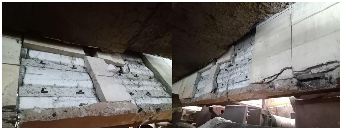
Figura 5.31. Região da porta seca que sofreu queda de blocos.
