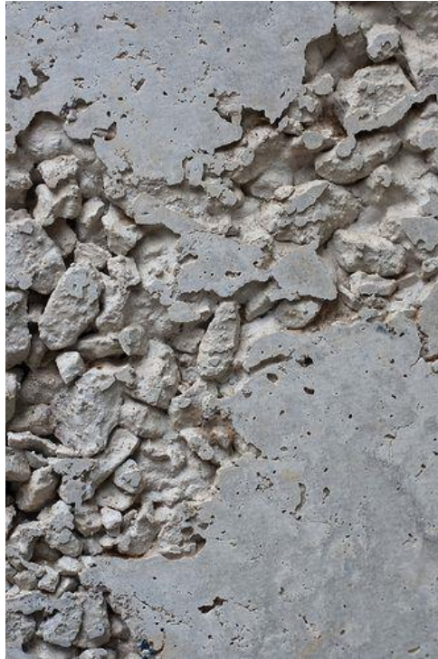
Figura 3 – Fenômeno de Segregação do Concreto. Fonte: Revista Construa (2020)
