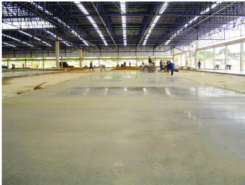
Figura 4 – Fenômeno de Exsudação no Concreto. Fonte: Catusso et al. (2015)
