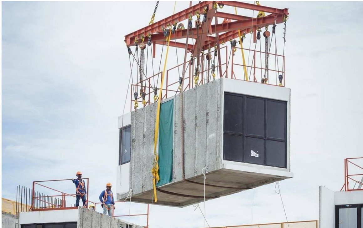
Figura 07 – Exemplo de construção modular volumétrica: módulo pré-fabricado é instalado no 17º andar em umas das torres do projeto Clement Canopy em Singapura / Malásia.
